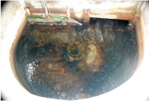
Entrada de água. 08/2006.
