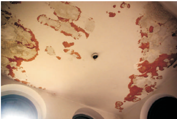
Infiltrações no teto da residência. 08/2006.
