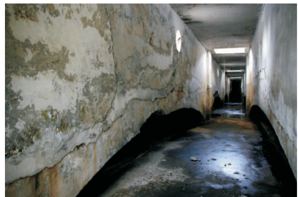
Infiltrações nas paredes do reservatório. 08/2006.
