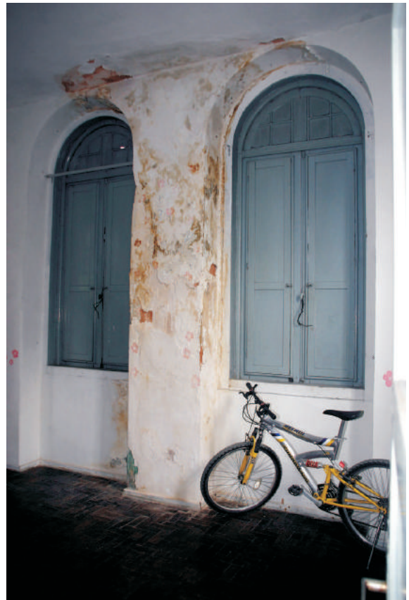
Infiltrações na parede da residência. 08/2006.
