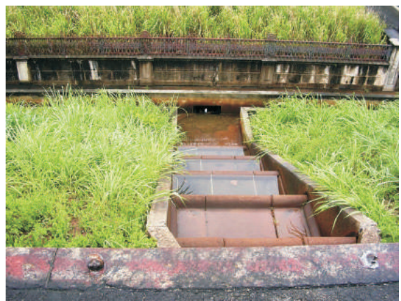
caixa alta, cascata de aeração e caixa baixa.
