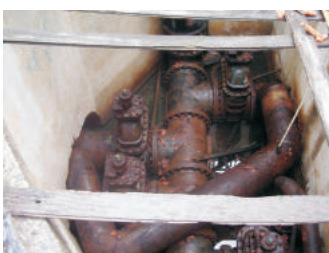
encanamentos no interior do pavilhão de manobras.
