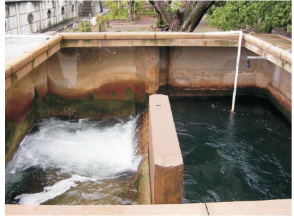
caixa de passagem da 2ª Adutora de Ribeirão das Lages
