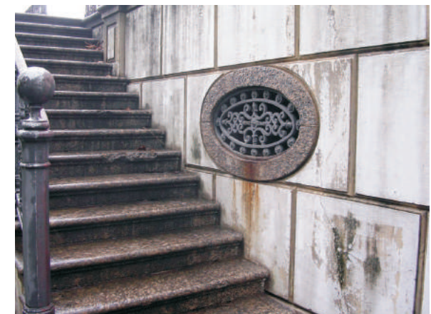
Escada na lateral da caixa alta voltada para a Rua Mal. Jardim. 08/2006.
