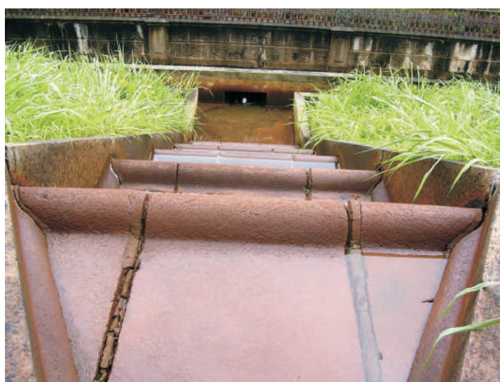
Cascata de aerção da caixa alta.
