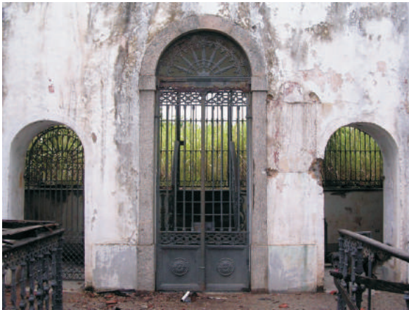
pavilhão de manobras atrás da caixa alta e escada de acesso ao topo da caixa.
