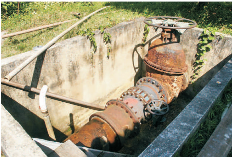
Equipamento junto ao reservatório. 08/2006
