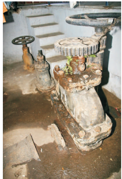
Equipamento na sala de manobras. 08/2006
