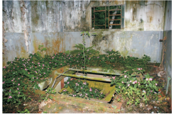
Interior do Posto de Tratamento.
