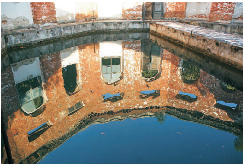
Reservatório sem teto (desabou). 08/2006.
