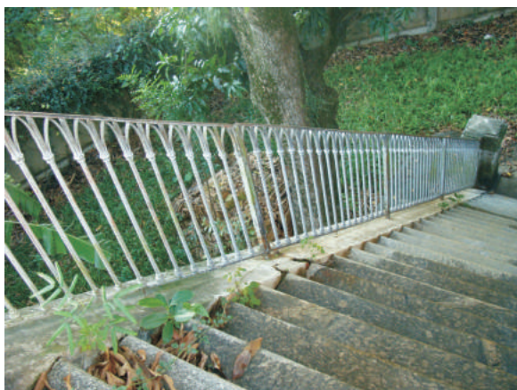
Gradil da escada. 07/2013.
