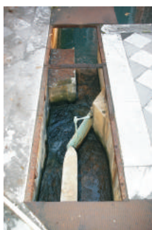
Entrada de água no reservatório, em atividade. 08/2006.
