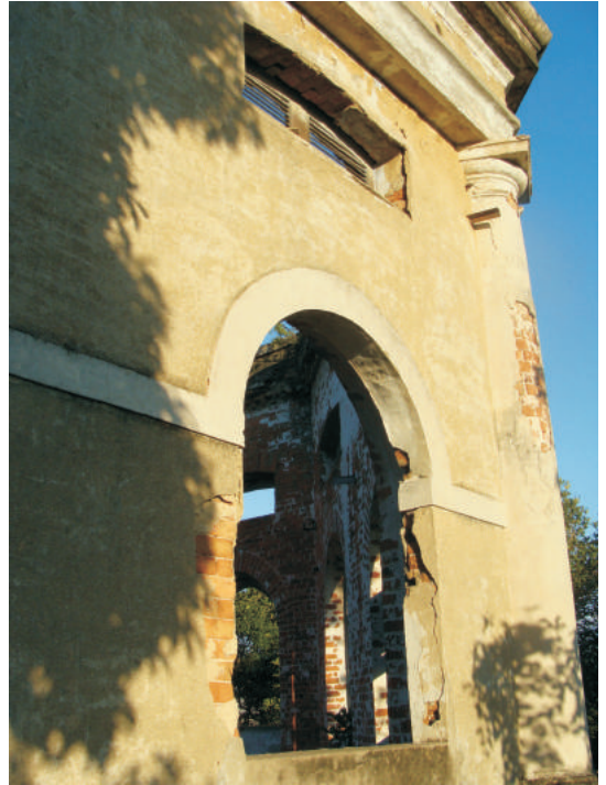
Revestimento da fachada externa deteriorando. 07/2013.
