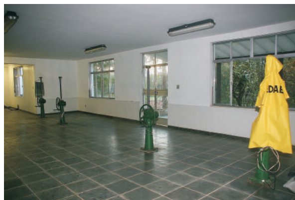
Sala de manobras. 08/2008
