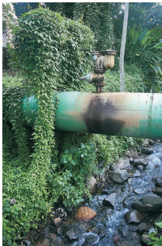
Adução dos reservatórios. 08/2008
