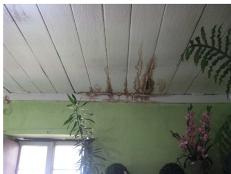
Presença de infiltração na edificação.
