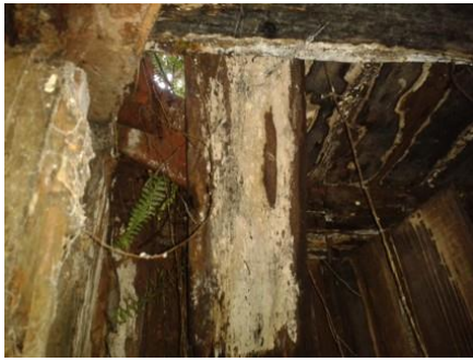
Foto 22. Casa enxaimel Vista do telhado danificado.
