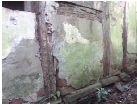
Foto 26. Casa enxaimel Estrutura de madeira. Desprendimento do reboco.
