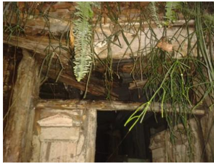
Foto 23. Casa enxaimel Vista do telhado danificado.
