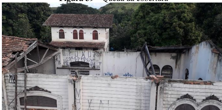
Figura 39 – Queda da cobertura
