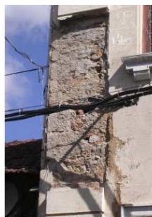
perda de revestimento
