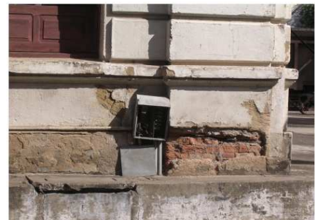
perda de revestimento
