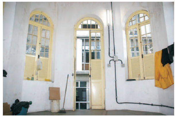
Interior da casa de manobras. Julho/2006
