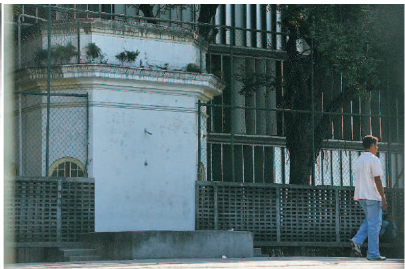
Casa de manobras. Julho/2006
