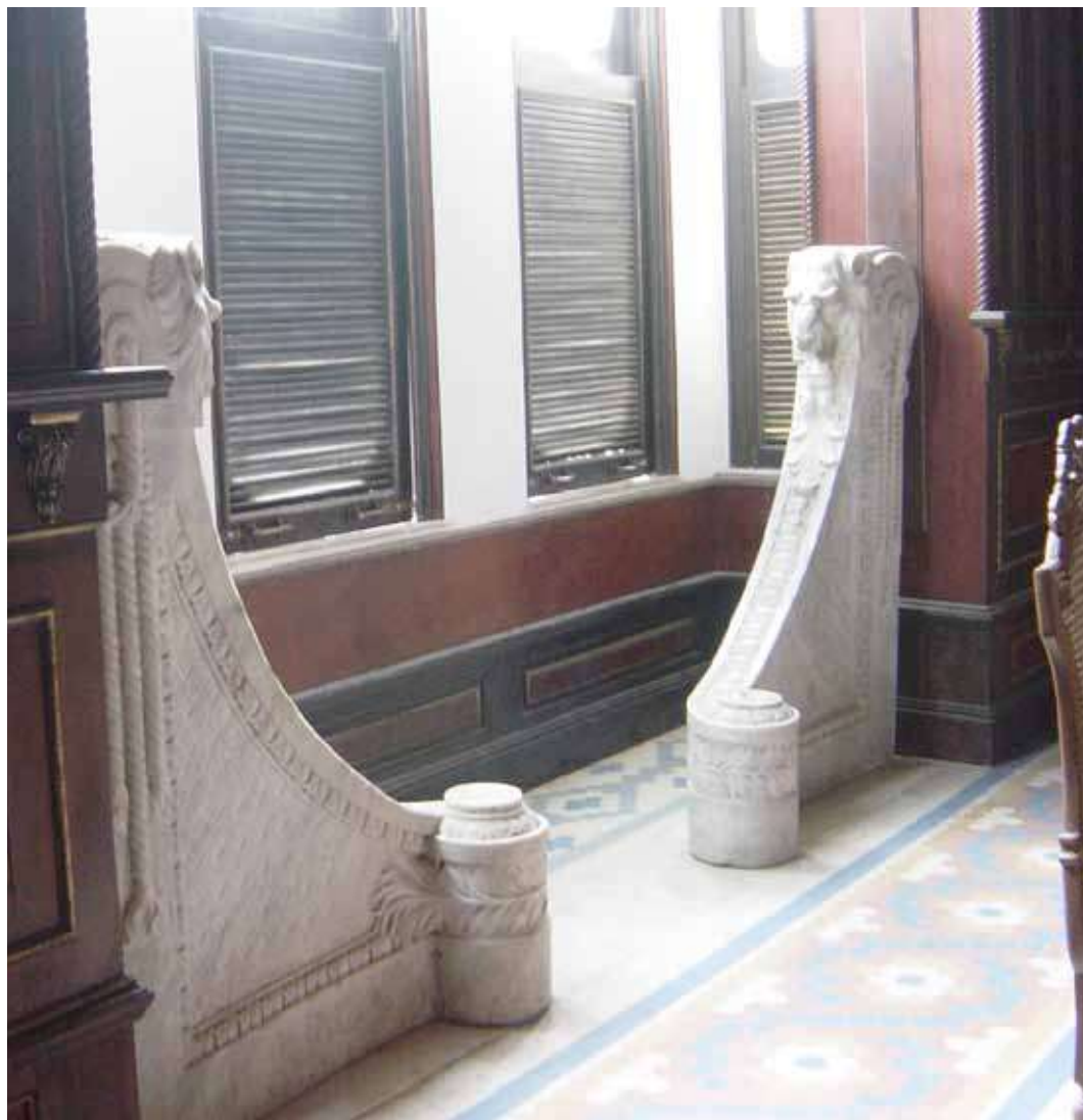
Foto 25 - Os arranques da escada social principal (leões) foram retirados do lugar original e colocados em local equivocado.
