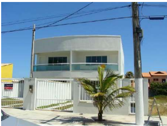
Figura 22 – Imóvel sem telhado cerâmico aparente. Fonte: a autora (2015).
