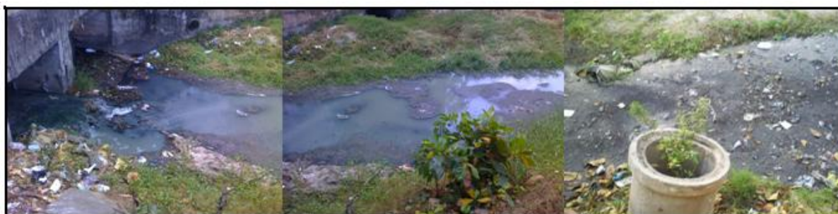
Figura 35 – Final do trecho canalizado e início do canal aberto do riacho Maceió Fonte: Arquivo Próprio (2009)
