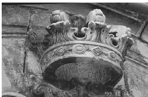
Depósitos escuros – Fachada da Igreja da Ordem Terceira do Carmo-Recife/PE
