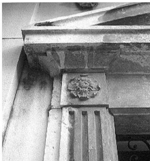
Corrosão em Pedra Lioz – Teatro Apolo – Recife/PE
