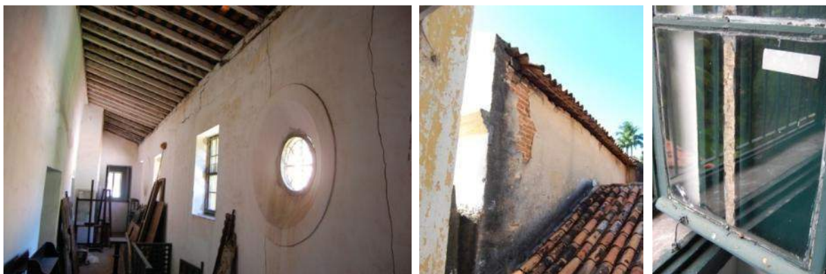
Figura 77 Presença de rachaduras na parede do primeiro pavimento, por cima do corredor dos mortos. Foto: Barbara Aguiar, fev./2009.
