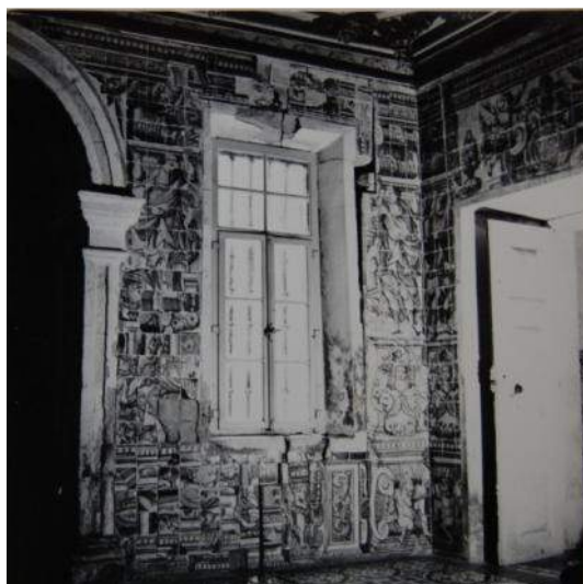
Figura 54 Foto da sacristia mostrando painel azulejar danificado e com peças em desalinho, cercadura da janela gravemente comprometida. Notar presença de esquadria de madeira e o piso em mosaico. 1975. Fonte: Acervo da Biblioteca Almeida Cunha – 5ªSR/Iphan, registro 4185/79.
