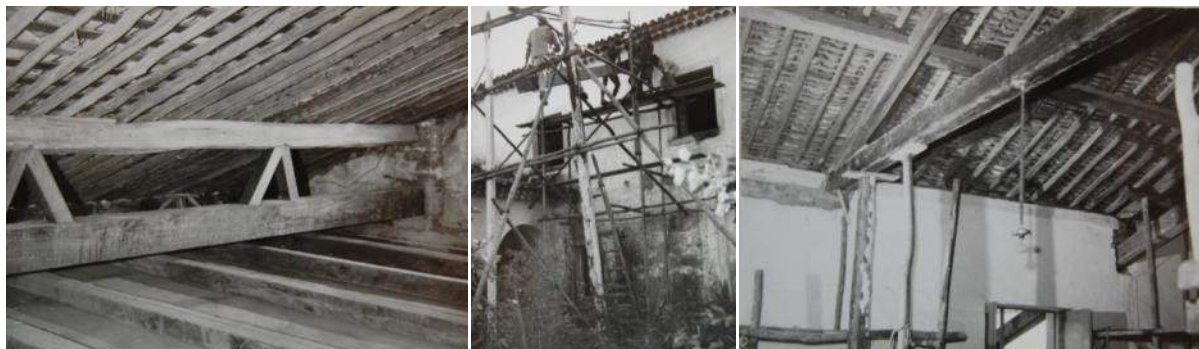
Figura 61 Intradorso da sacristia da Ordem Terceira de São Francisco de Olinda, detalhe para reforço da mais baixa, apoiando-se em uma terça mais nova. Observa-se a utilização de caibros roliços e ripões serrados. Fonte: Documentário de obras, agosto de 1983. Acervo da Biblioteca Almeida Cunha – 5ªSR/Iphan, registro nº 5071/83.
