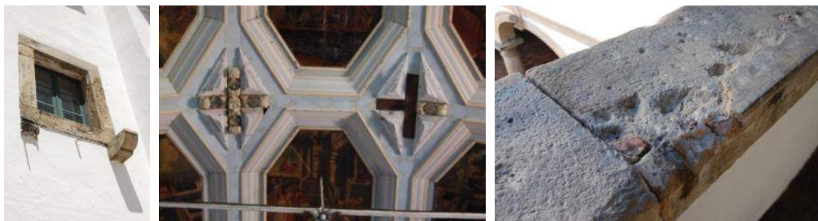
Figura 72 Ausência de um dos cachorros em cantaria da janela de uma das celas do primeiro pavimento. Percebe-se, também, deterioração da cantaria de sua cercadura. Foto: Barbara Aguiar, fev./2009.
