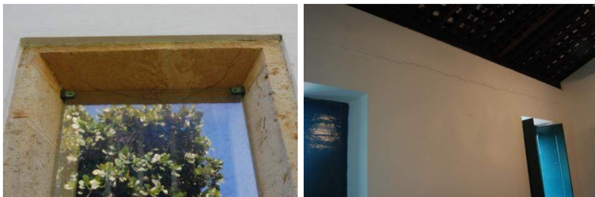
Figura 80 Rachadura na cercadura da janela da sacristia. Foto: Barbara Aguiar, fev./2009.
