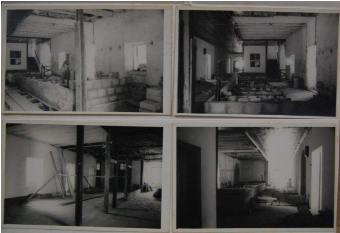
Figura 46 Construção clandestina dos sanitários no interior do convento: primeiro pavimento nas fotos superiores, e nas inferiores, segundo pavimento. 1967. Fonte: Acervo da Biblioteca Almeida Cunha – 5ªSR/Iphan, registros: 9056/86 a 9069/86.
