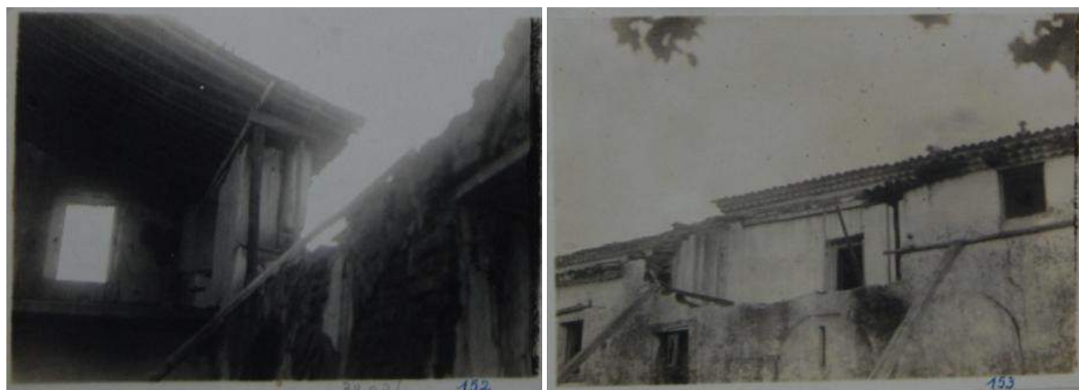
Figura 37 Vista interna do Salão Pio X após seu desmoronamento. Fonte: Acervo da Biblioteca Almeida Cunha – 5ªSR/Iphan, registro nº 3099/75.
