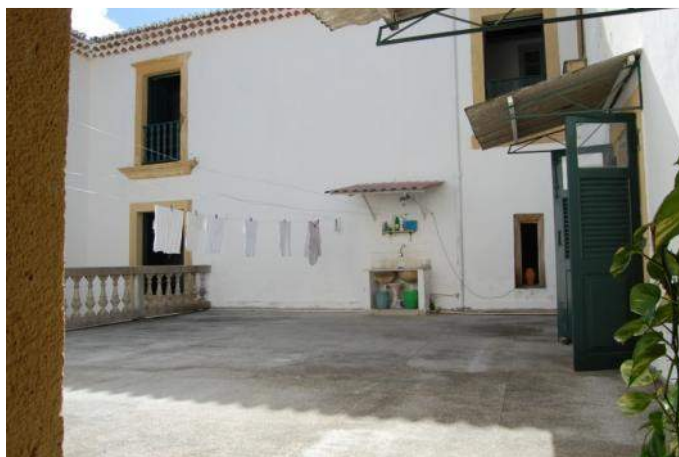
Figura 50 Varanda localizada no primeiro pavimento do bloco das celas conventuais, que atualmente serve como lavanderia particular dos frades. Notar marquises feitas para proteger o tanque, a porta e as janelas, em telha de fibrocimento e estrutura metálica. Foto: Barbara Aguiar, fev./2009.
