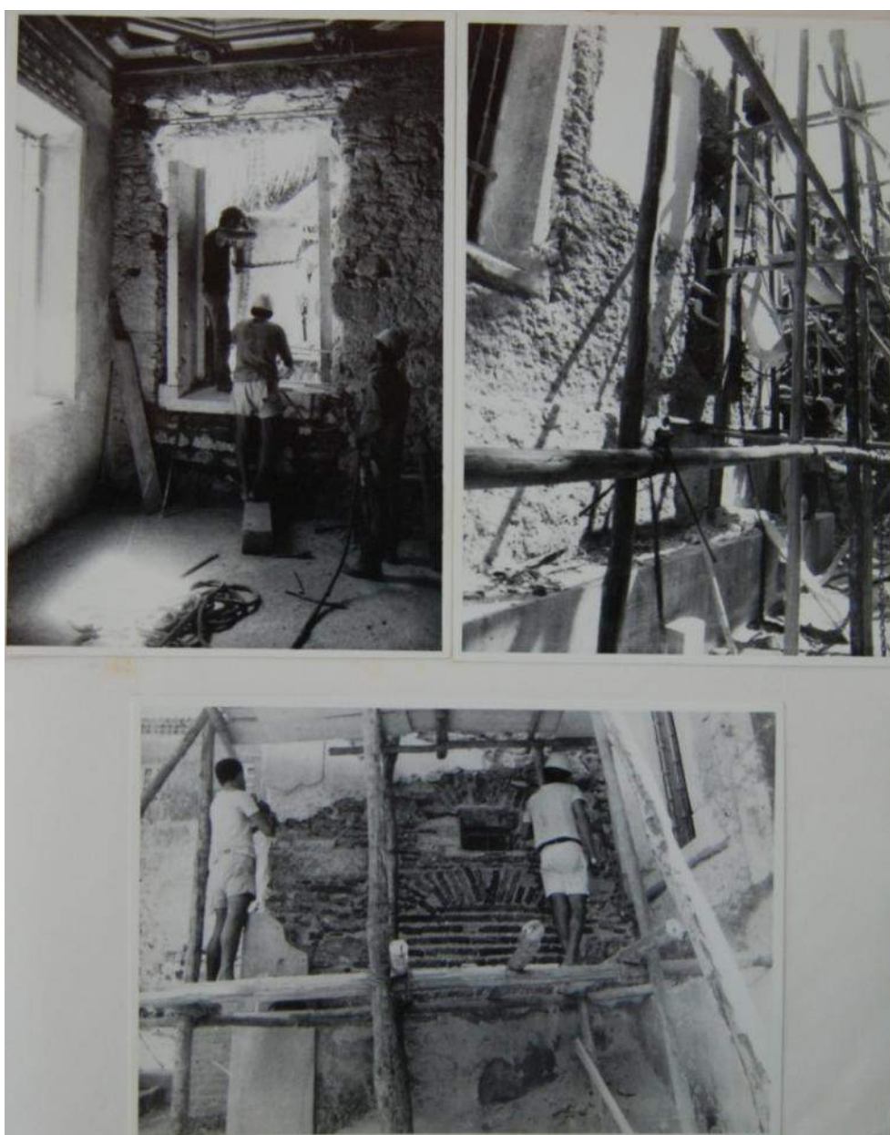
Figura 57 Fotos mostrando obras de restauro e consolidação estrutural da sacristia, 1984. Fonte: Acervo da Biblioteca Almeida Cunha – 5ªSR/Iphan, registros: 6999/84, 7000/85 e 7001/85.
