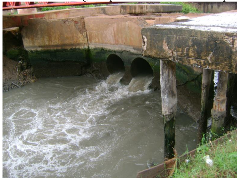
Figura 20 – Redes de esgotos que dificultam o trabalho do pescador.
