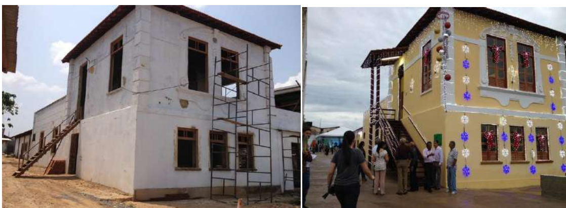
Figura 12. Obras de restauro e inauguração do prédio da Antiga Câmara Municipal em 2014. Fonte: www.gi.globo.com/ro
